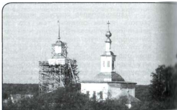
Недалек день, когда покрасят всю колокольню и снимут с нее леса, оцинкуют оставшиеся крыши - и засияет храм Святой Троицы во всём своём светлом великолепии
